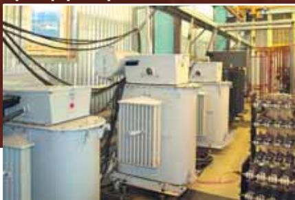
Рис. 5. Повышающие трансформаторы стэнда
